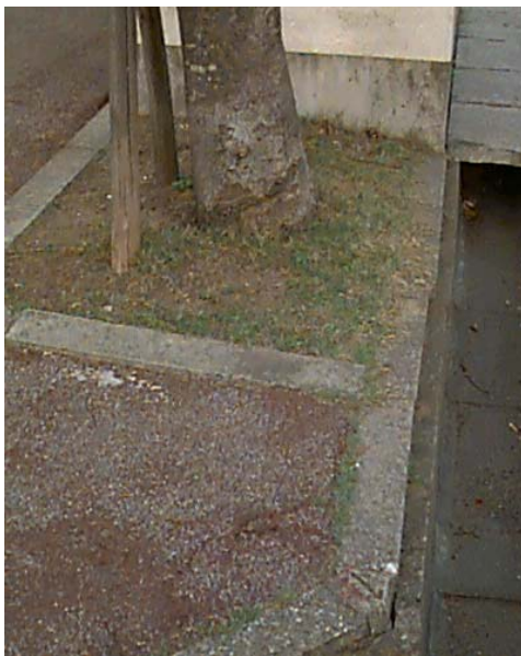
写真3 集会所南側のケヤキにより 押しやられたU字溝
