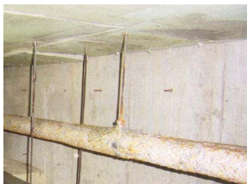
【写真3】正常な支持金物
