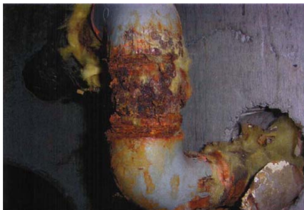
【写真1】2 号棟115 号床下の配管の下側エルボ配管の上部の直管のネジ部が腐食により減肉し、ライニング部分を残すのみの状態
