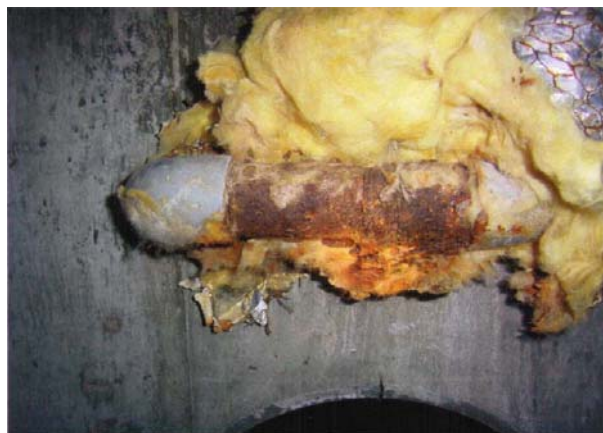
【写真2】本来は下の写真 3 のように配管の中央に支持金物があるが、腐食により完全に支持金物がなくなった状態(2 号棟115 号床下)
