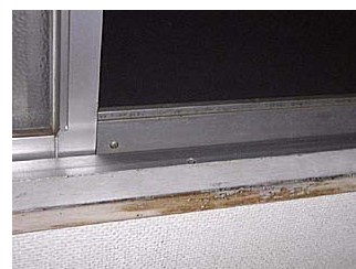
図 58 吐き出し窓の窓枠の塗装の劣化
