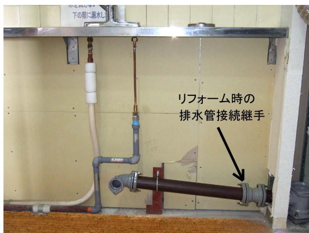
図 9 既存のキッチンの配管
