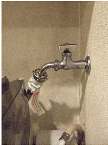
〔既存の洗濯機用水栓〕
