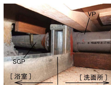
図 10 洗面所床下配管
