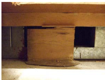
【浴室の扉前の床下の木製ブロック】
