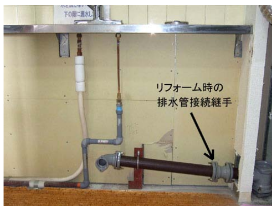
[改修したキッチン系統の排水管] (2008 年)
