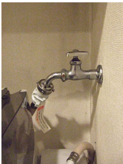
既存の洗濯機用水栓
