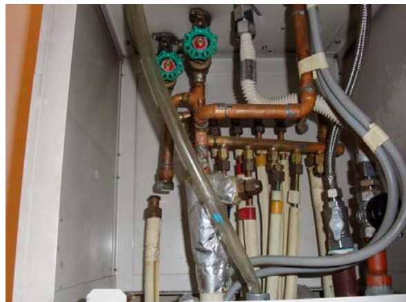
バスヒーターは使わないため、TESのところでプラグ止め
