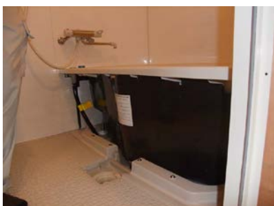
サーモバスの設置状況
